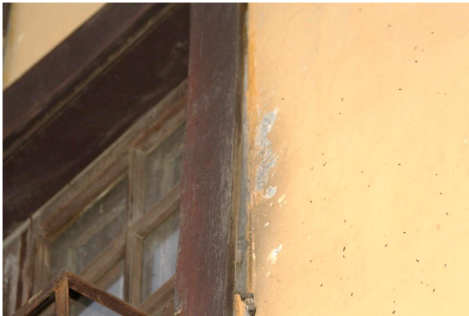
Figura 18. Una de las salidas de la colonia, donde se observa el raspado a la pintura ocasionado por las uñas de los murciélagos cuando se agarran del muro al momento de volver a la colonia.
