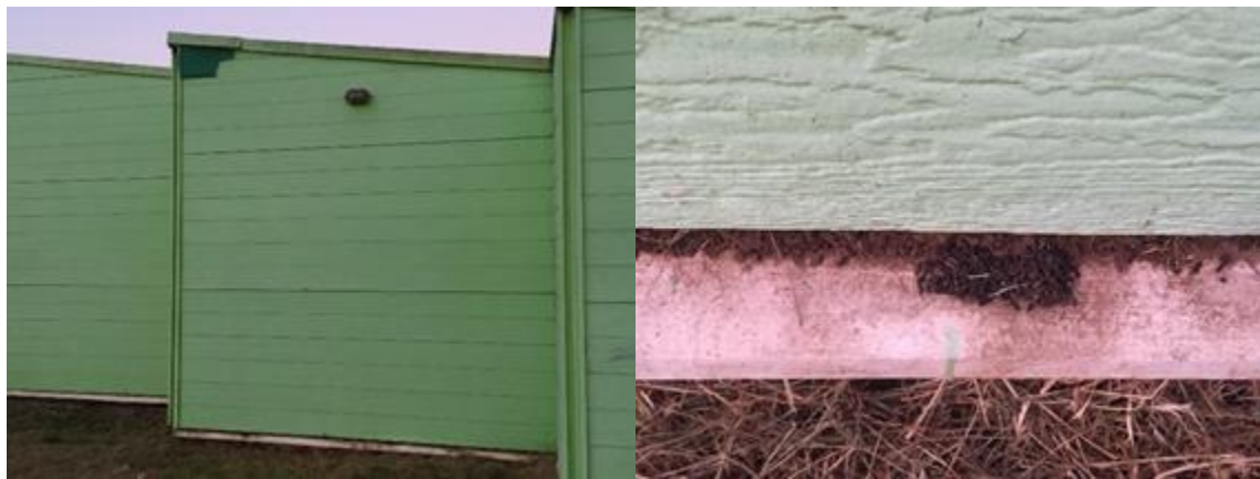
Figura 21. Colonia de quirópteros en el jardín infantil. (Izq) Esclusa hecha de malla mosquitera tapando la salida de la colonia establecida en el jardín infantil “Los Rulitos”. (Der) Cúmulo de guano de murciélago saliendo por el espacio del muro donde estaba la colonia y el revestimiento. Fotografías: Ignacio Fernández.
