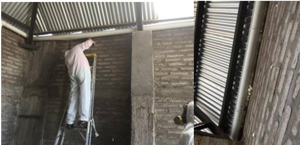
Figura 25. Proceso de sellado de la colonia. (Izq) Personal municipal en proceso de aplicación de espuma expansiva. (Der) Espuma en el espacio entre el muro y la canaleta. Fotografías: Ignacio Fernández.
