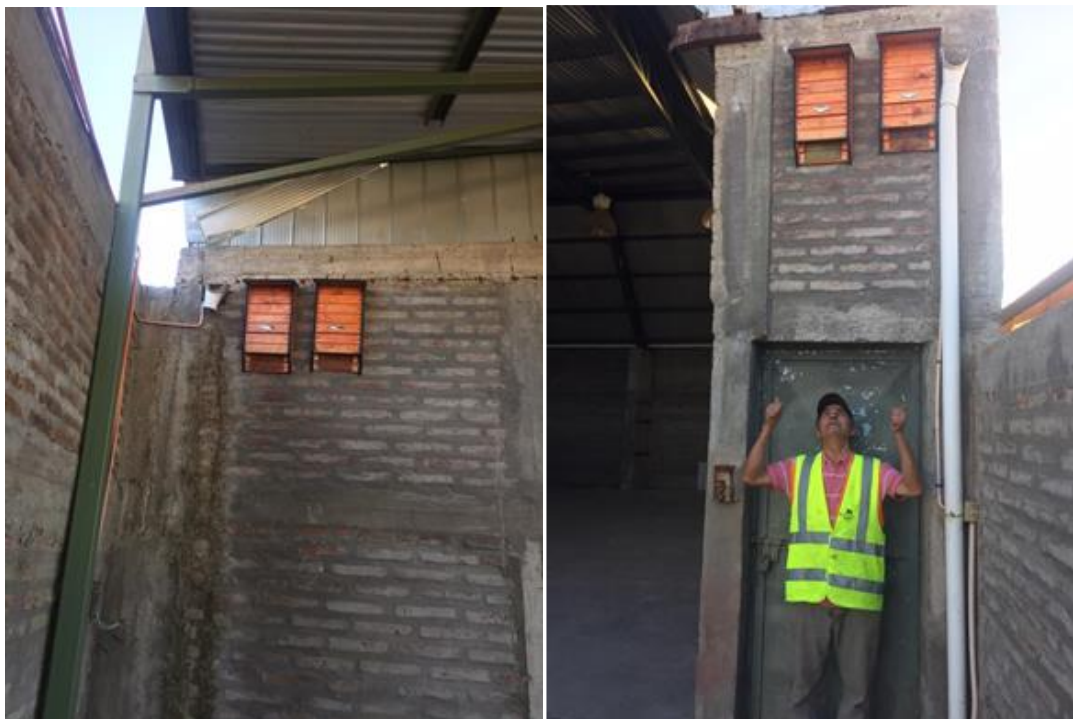
Figura 23. Casetas para murciélagos instaladas. (Izq.) Casetas instaladas al borde izquierdo del galpón. (Der.) Casetas instaladas al borde derecho del galpón y con referencia de la altura a la cual fueron instaladas.
